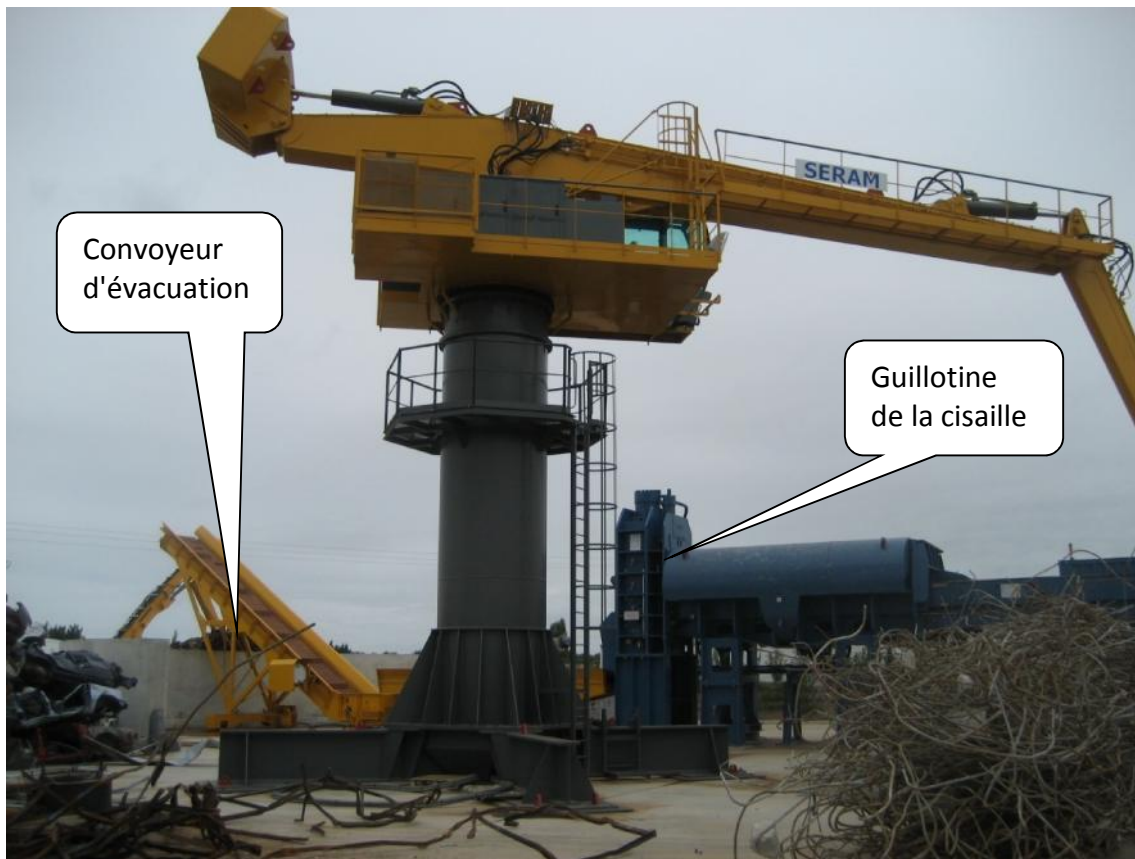
Photo de l'installation du site de Migné-Auxances (86440)
